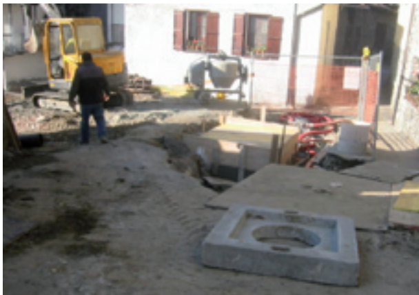
Acquedotto in località Bagnère
